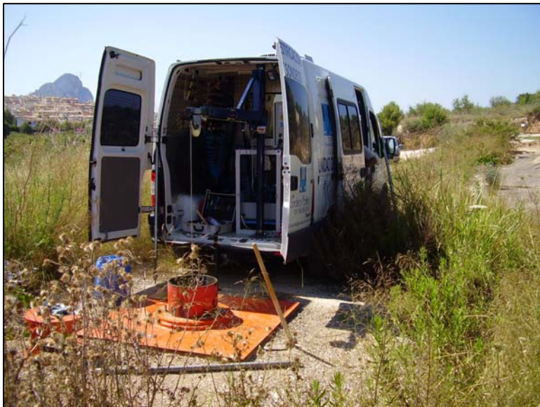
Fotografía 2: Detalle del equipo instalado en el sondeo.
